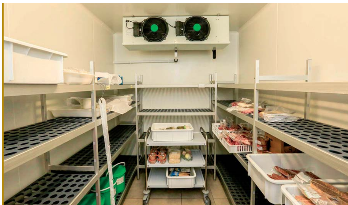
Les frigos sont équipés d'une climatisation qui permet de conserver une fraîcheur homogène dans tout le local.
